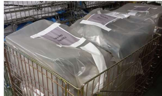
Fig. Filtres de ventilation
