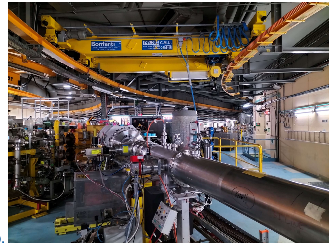
Vue dans le tunnel du PS (Synchrotron à Protons).
